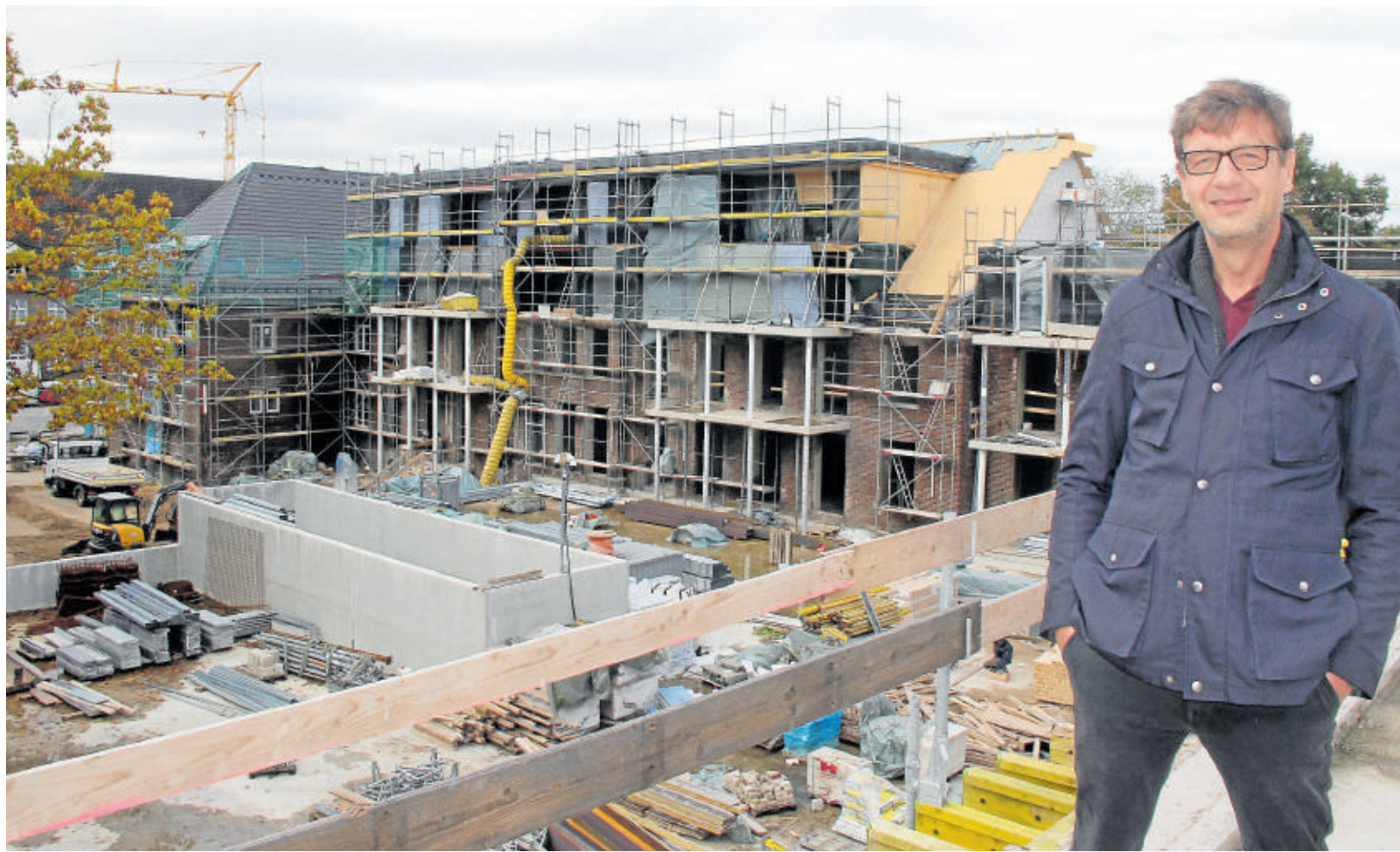
Matthias Korff inspiziert seine Baustelle: Die alten Mannschaftsgebäude sind ökologisch saniert und werden zu Seniorenwohnungen. Fotos: Michaelis
