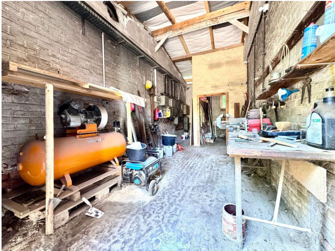
Elektro- und Kompressorraum
